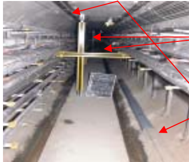
図5 光ファイバセンサ設置状況
