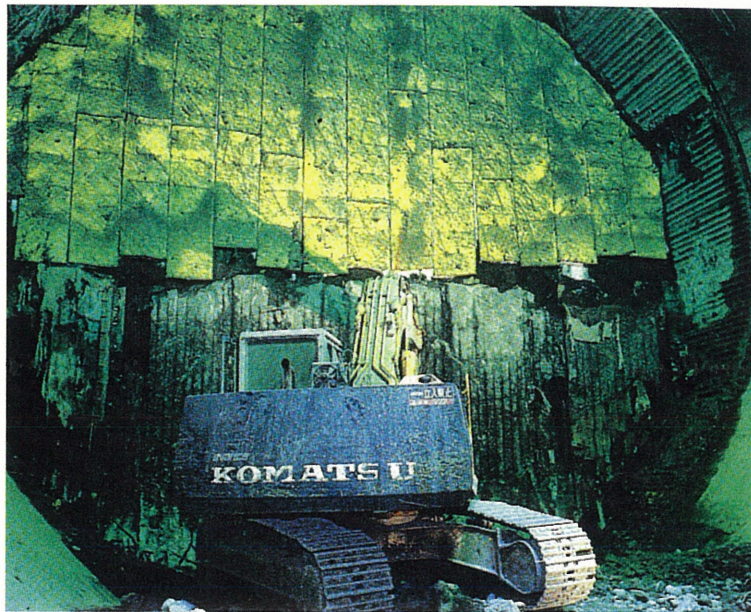
口絵写真—26 川崎人工島（風の塔）開口部における発破撤去後の状態 開口部上半は断熱材（黄色）で覆われている。
