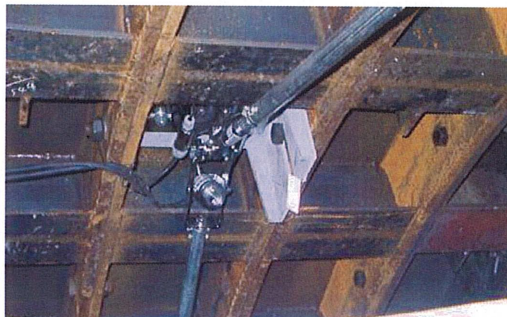
写真-1 ユニバーサル内空変位計設置状況 (シールド掘進直後のトンネル内に設置することから、内空側への突出を避けるため、箱部空間を利用した。)
